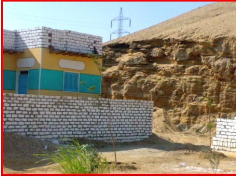
صورة (٧) : خطورة احتمالية تعرض بناء الوحدات السكنية فى حضبيض المنحدرات بمنطقة سدمنت الجبل لسقوط صخرى محتمل. ناظراً اتجاه الجنوب الغرب
