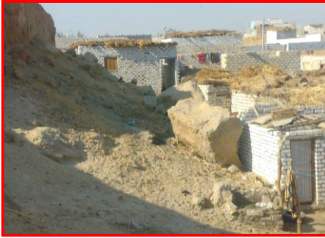
صورة (١٠) : أخطار السقوط الصخري على الوحدات السكنية المبنية فى حضيض المنحدرات بمنطقة سدمنت الجبل. وتمثل منطقة خطر سقوط صخري شديد جداً. ناظراً اتجاه الغرب
