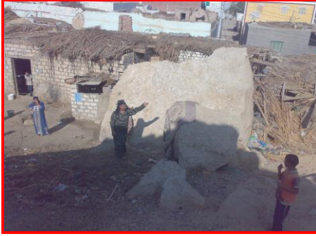
صورة (٩) : تدمير أحد المنازل نتيجة عملية سقوط صخري لإحدى الكتل الصخرية كبيرة الحجم بمنطقة سدمنت الجبل عام ٢٠٠٨. كما يلاحظ وقوف صاحبة المنزل فوق إحدى الكتل الصخرية الساقطة المندثرة تحت الرواسب على نفس المنطقة عام ٢٠٠٥. ناظراً اتجاه الشمال الغربي
